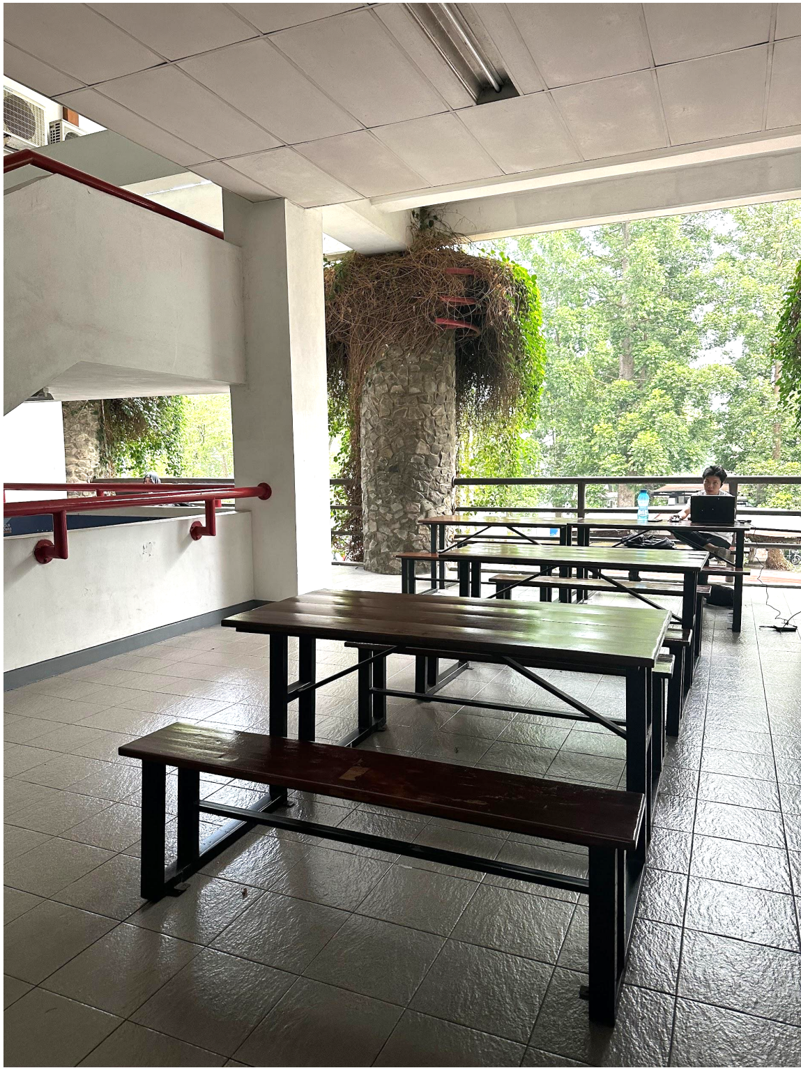
Gambar 3. Kondisi co-working space lantai 2 yang ingin diperbaiki
